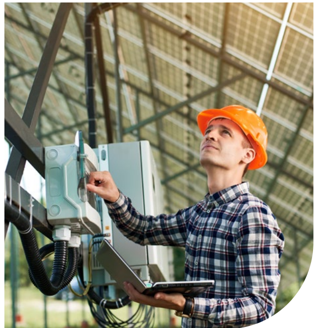
Die Wartung der Wechselrichter muss in regelmäßigen Abständen stattfinden
