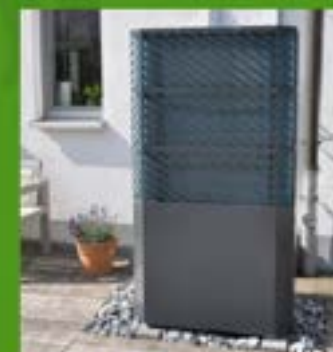
Wärmepumpen als zukunftsfähige Heizmethode
